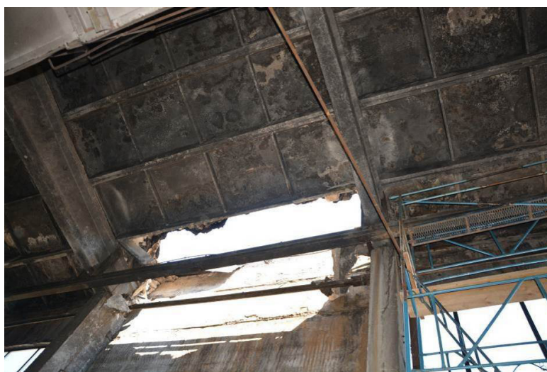
Рис. 2. Общий вид аварийного обрушения плиты покрытия III очереди строительства котельной на участке в осях «3-4, К» (вид изнутри)
