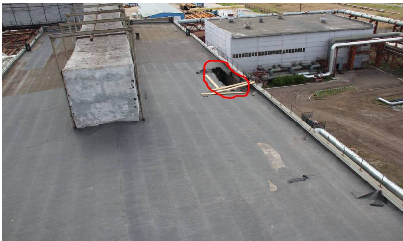
Рис. 1. Общий вид аварийного обрушения плиты покрытия III очереди строительства котельной на участке в осях «3-4, К» (вид сверху)
