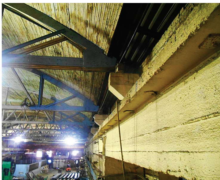
Рис. 3. Общее техническое состояние сборных железобетонных подкрановых балок
