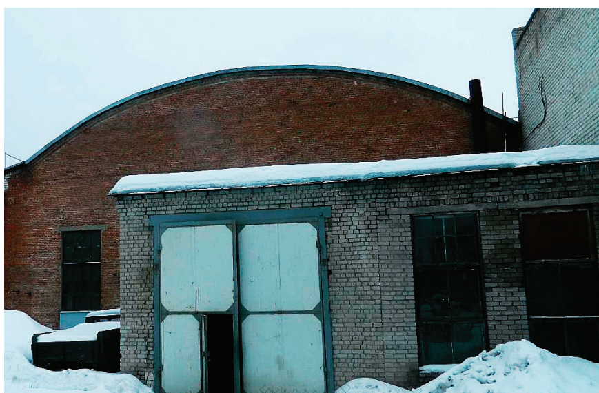
Рис. 1. Фасад пролета (литер А) корпуса № 9 с пристройкой на момент проведения обследовательских работ 10.02.2016 г.
